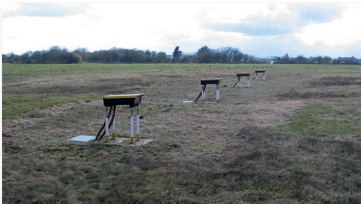
Photo d'un PAPI installé sur un sol en pente. Pour compenser la pente et afin que les unités soient positionnées selon les tolérances décrites ci-dessus, chaque unité du PAPI est positionnée à une hauteur différente.
