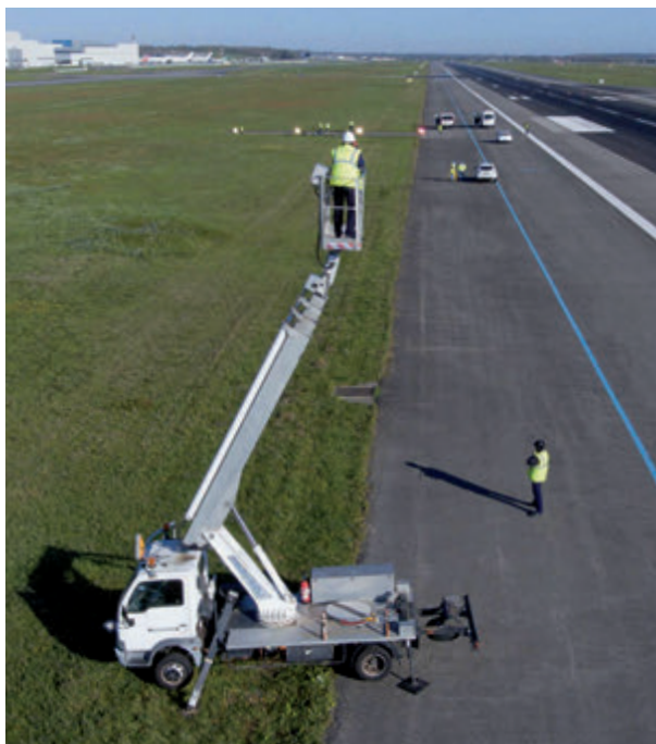
Figure 64 : Nacelle positionnée pour la mesure de l'angle de calage en site d'une unité lumineuse d'un dispositif PAPI - Aéroport de Toulouse Blagnac.
