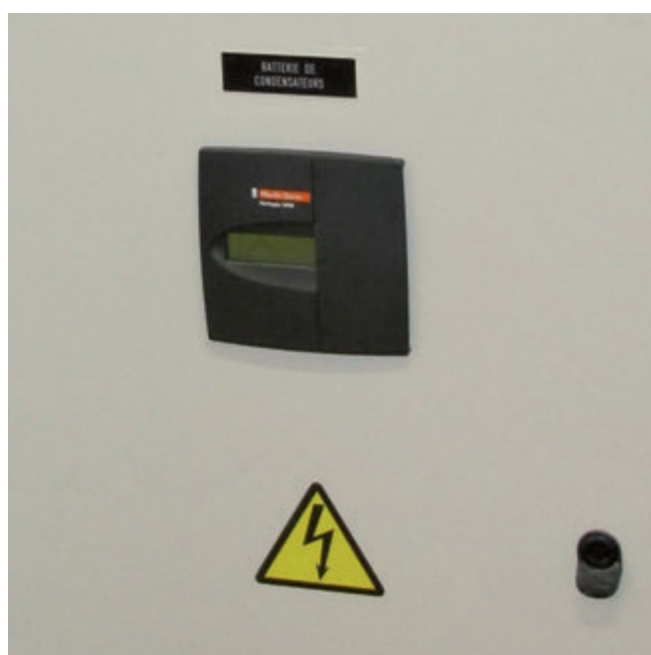
Figure 28: Batterie de condensateurs BT – Aéroport de Tahiti FAA'A
