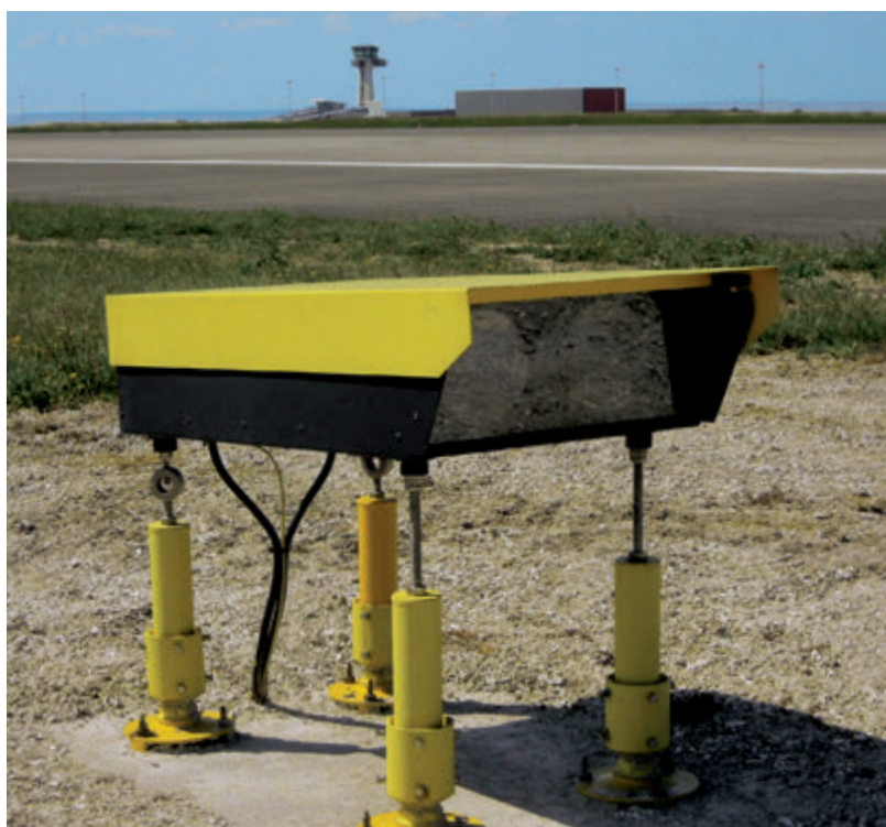
Figure 43: Unité lumineuse d'un dispositif PAPI - Aéroport de Châlons Vatry.
