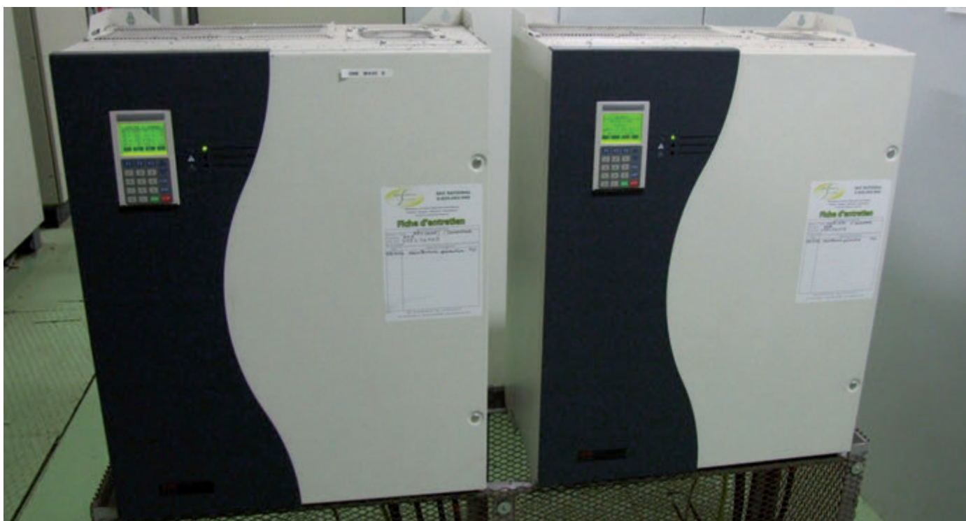
Figure 29: Compensateur actif d'harmoniques SineWave 60 A – Aéroport de Paris CDG.
