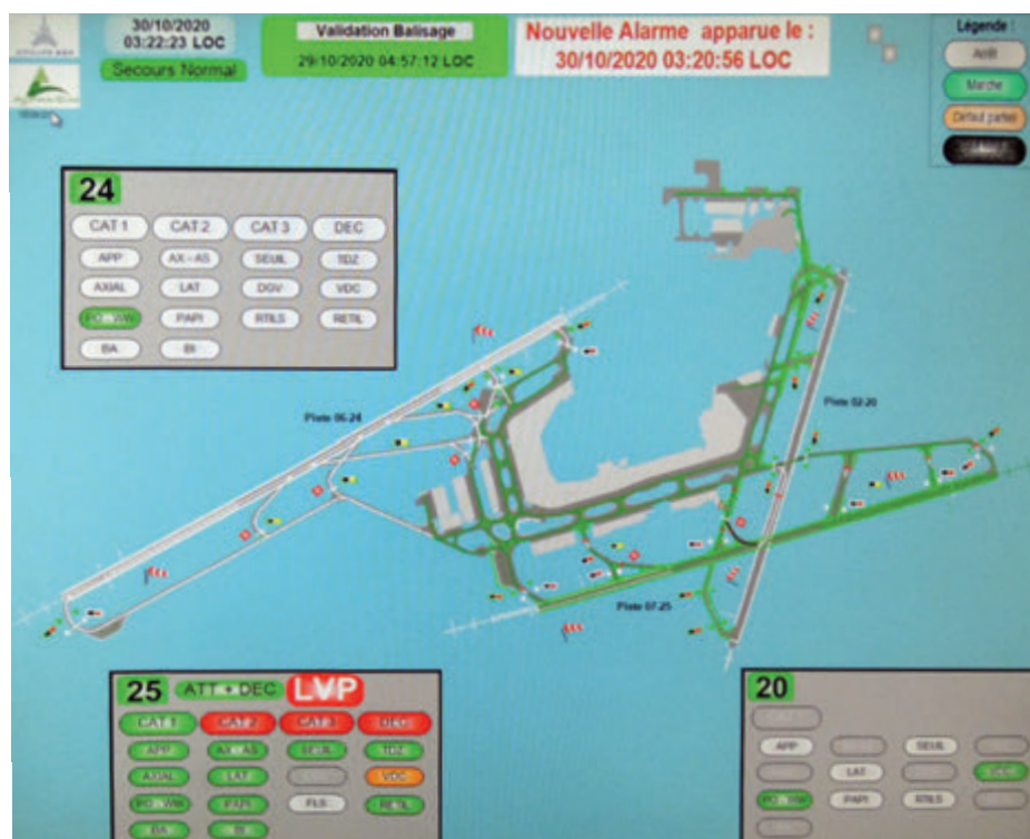
Figure 35 : Platine de contrôle et de commande du balisage lumineux – Aéroport de Paris Orly.
