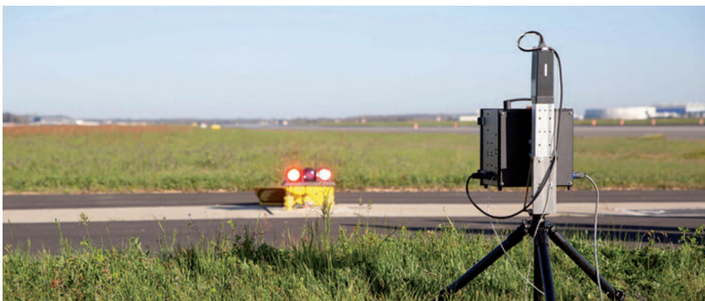
Figure 72: Mesure de l'angle de calage en site d'une unité lumineuse d'un dispositif PAPI par la méthode de mesure au sol – Aéroport de Toulouse Blagnac.
