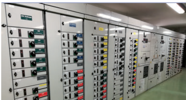
Figure 3: Poste électrique relatif au balisage lumineux – Aérodrome de Paris CDG.
