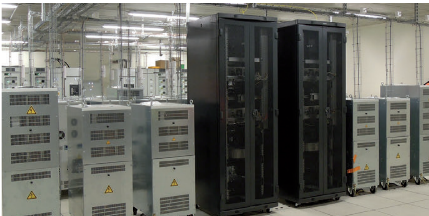
Figure 17: Poste électrique pour l'alimentation des dispositifs de balisage lumineux – Aéroport de Paris Orly.
