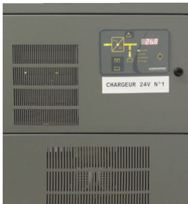
Figure 31: Redresseur/Chargeur 24 V DC - Aéroport de Toulouse Blagnac.
