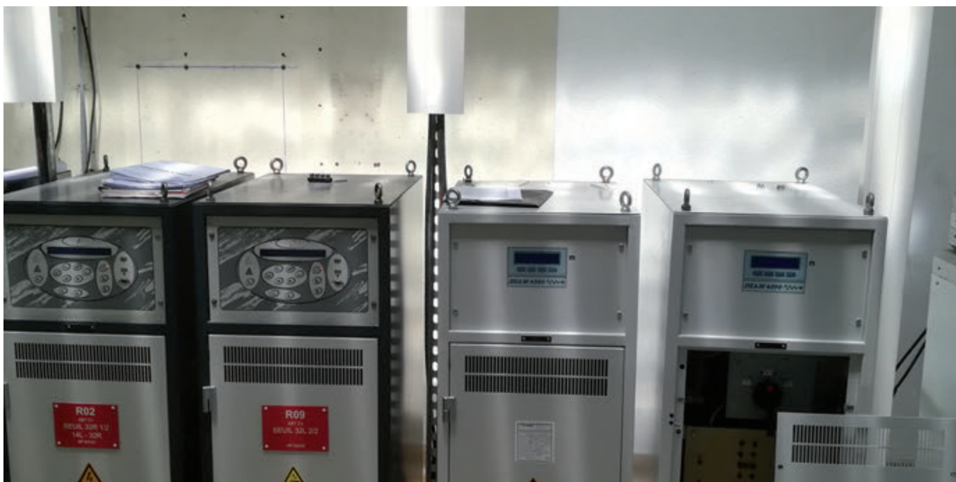
Figure 18: Poste électrique pour l'alimentation électrique des dispositifs de balisage lumineux – Aéroport de Toulouse Blagnac.
