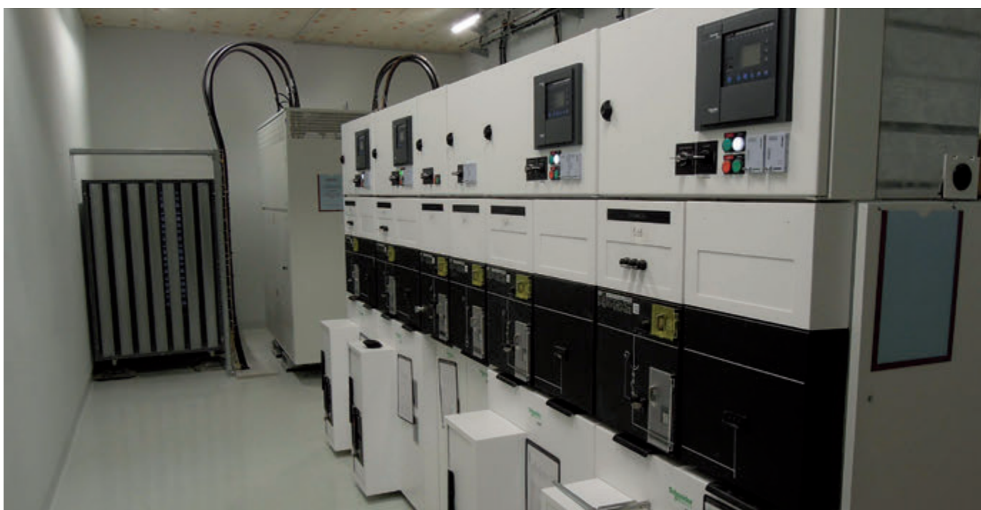
Figure 19: Poste HTA – Aéroport de Marseille.
