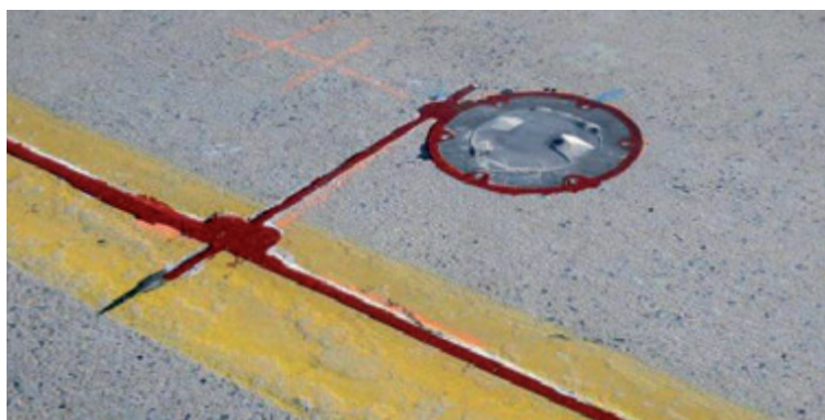
Figure 38: Saignée sur une piste en béton.
