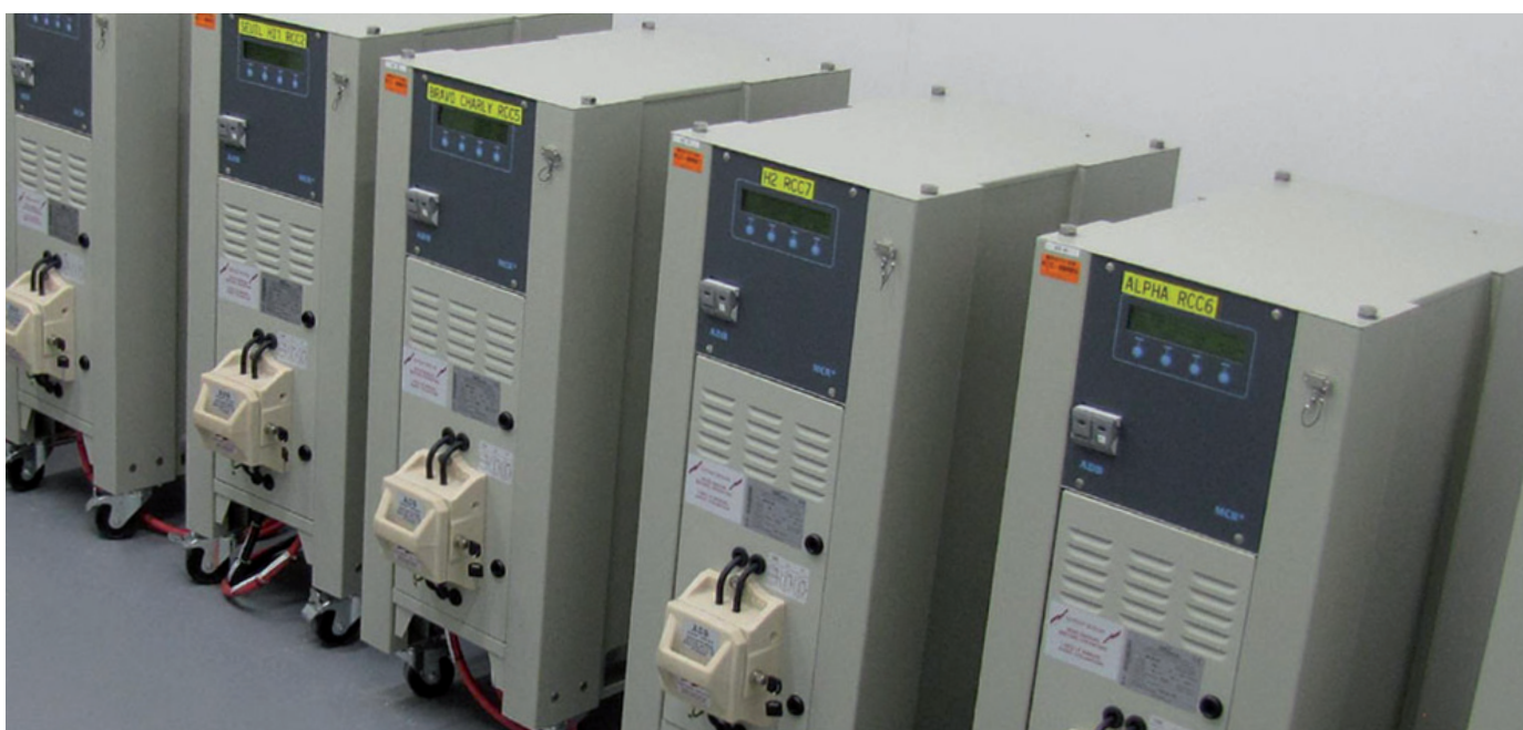
Figure 34 : Régulateurs à courant constant à thyristors – Aérodrome de Pointe A Pitre.
