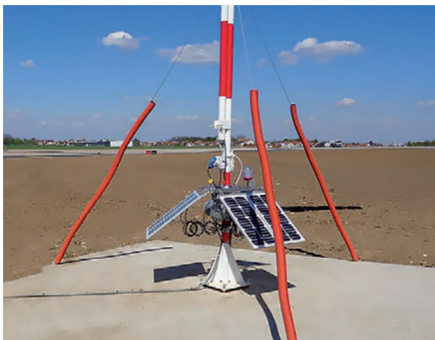
Figure 37: Massif support d'un indicateur de direction du vent - Aérodrome de Paris Orly.
