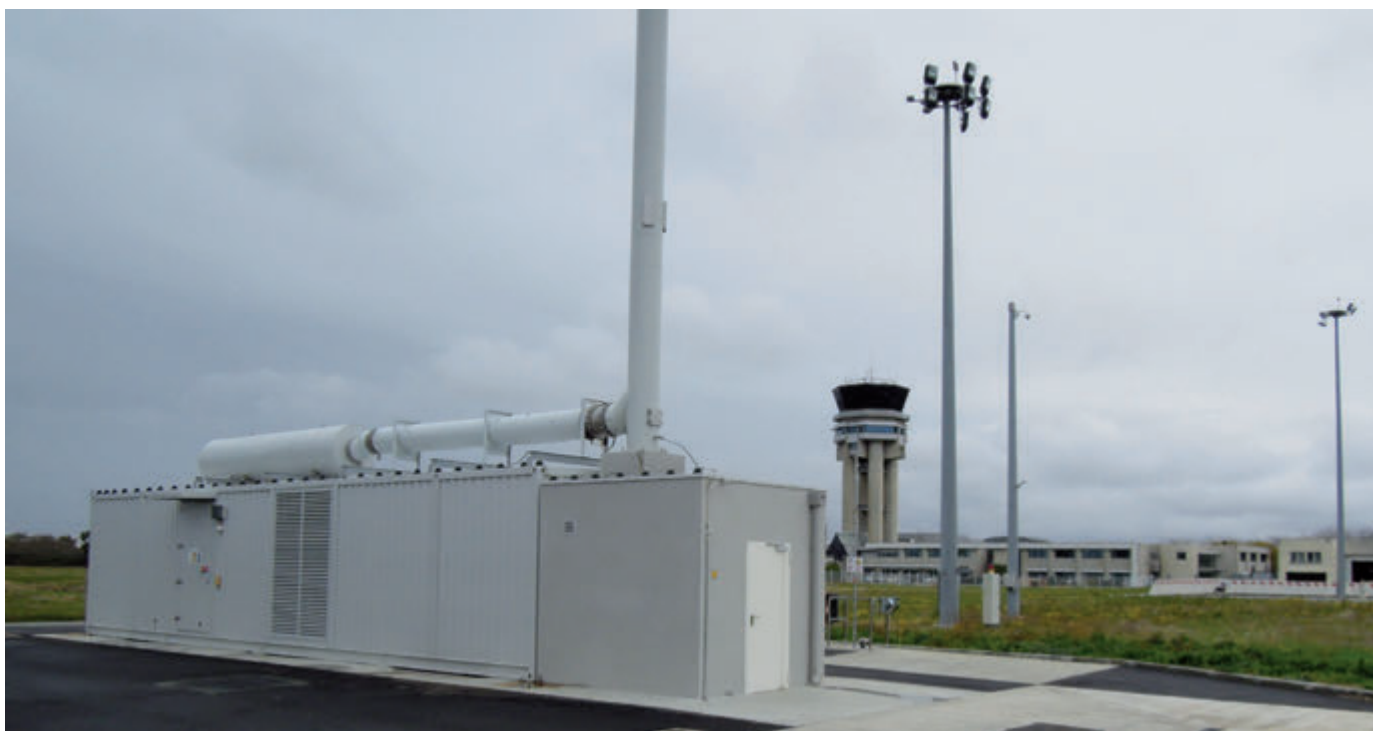
Figure 26: Système no-break en container – Aéroport de Toulouse Blagnac.
