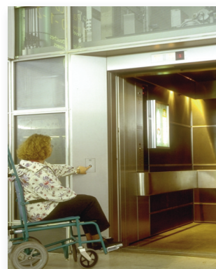
Ascenseurs - Aéroport de Paris-CDG 2C
