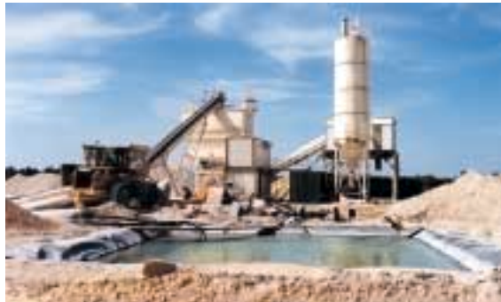
Aéroport de Châlons-Vatry : centrale de fabrication de béton et sa réserve d'eau de gâchage
