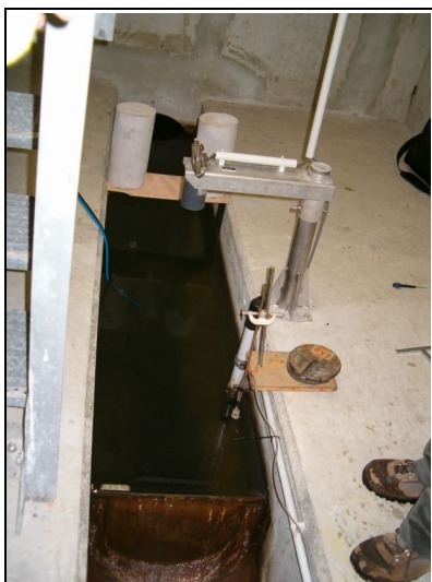
Figure 7 : Canal d'arrivée dans la station de mesures
