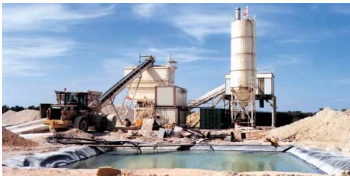
Châlons-Vatry : centrale de fabrication du béton - réserve d'eau de gâchage
