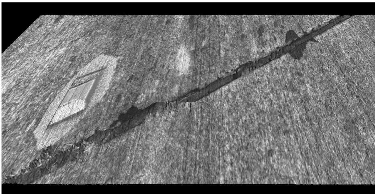
Un défaut de joint, que la présence de végétation rend élevé.
