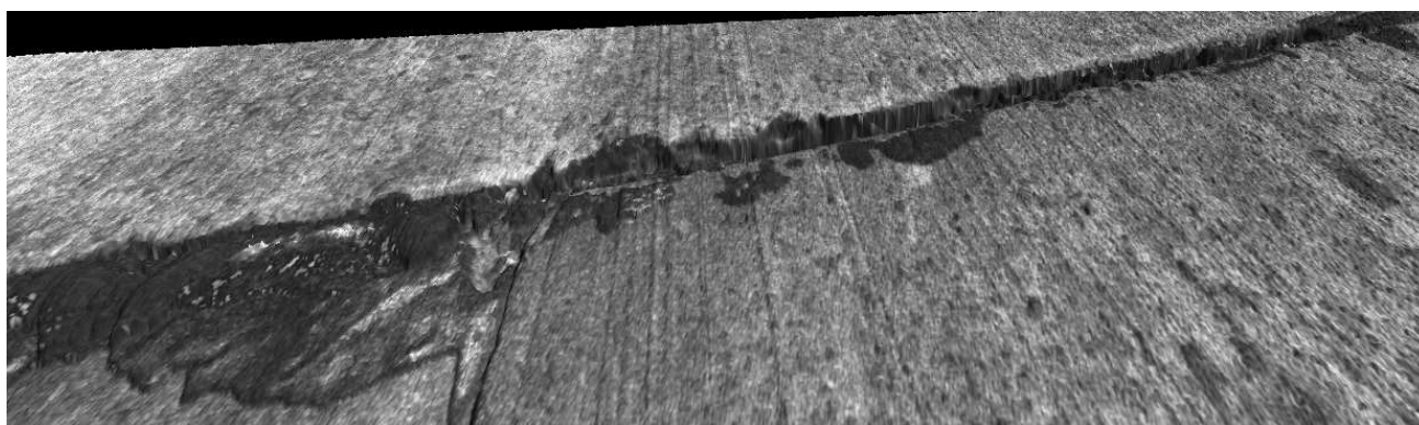
Exemple de résultat en vue 3D : on distingue un défaut de joint entre 2 dalles, une marche et une réparation sur le coin d'une dalle.
