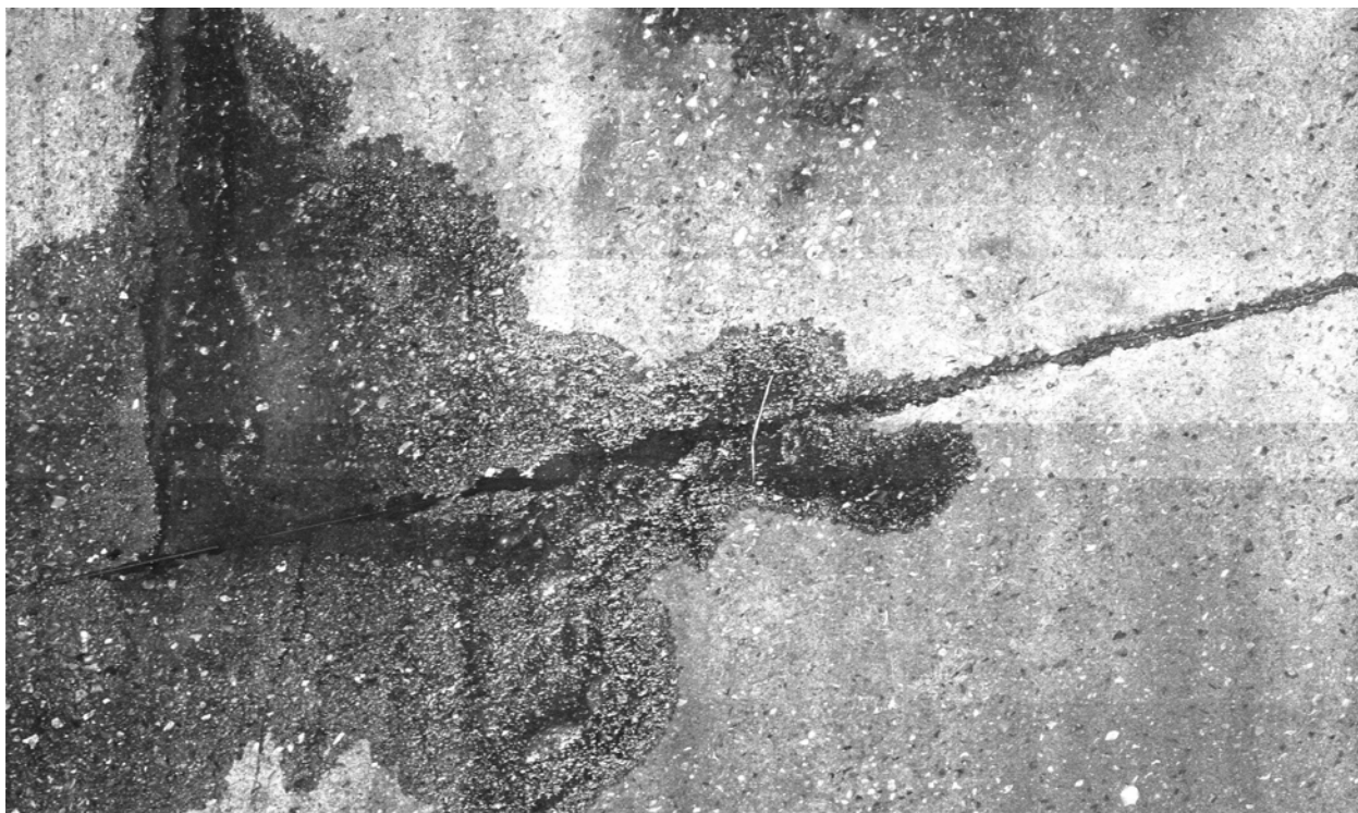
Une dégradation de pompage sur un joint de dalles.
