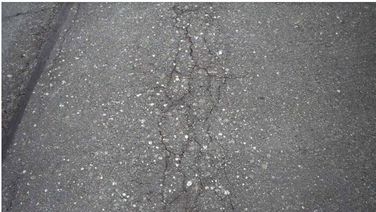
Faïençage de fatigue vu par l' IRCAN .
