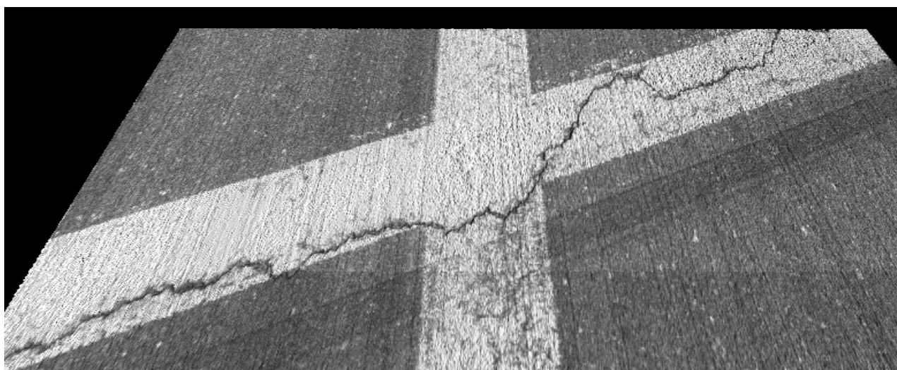
Fissure moyenne sur marquage au sol.
