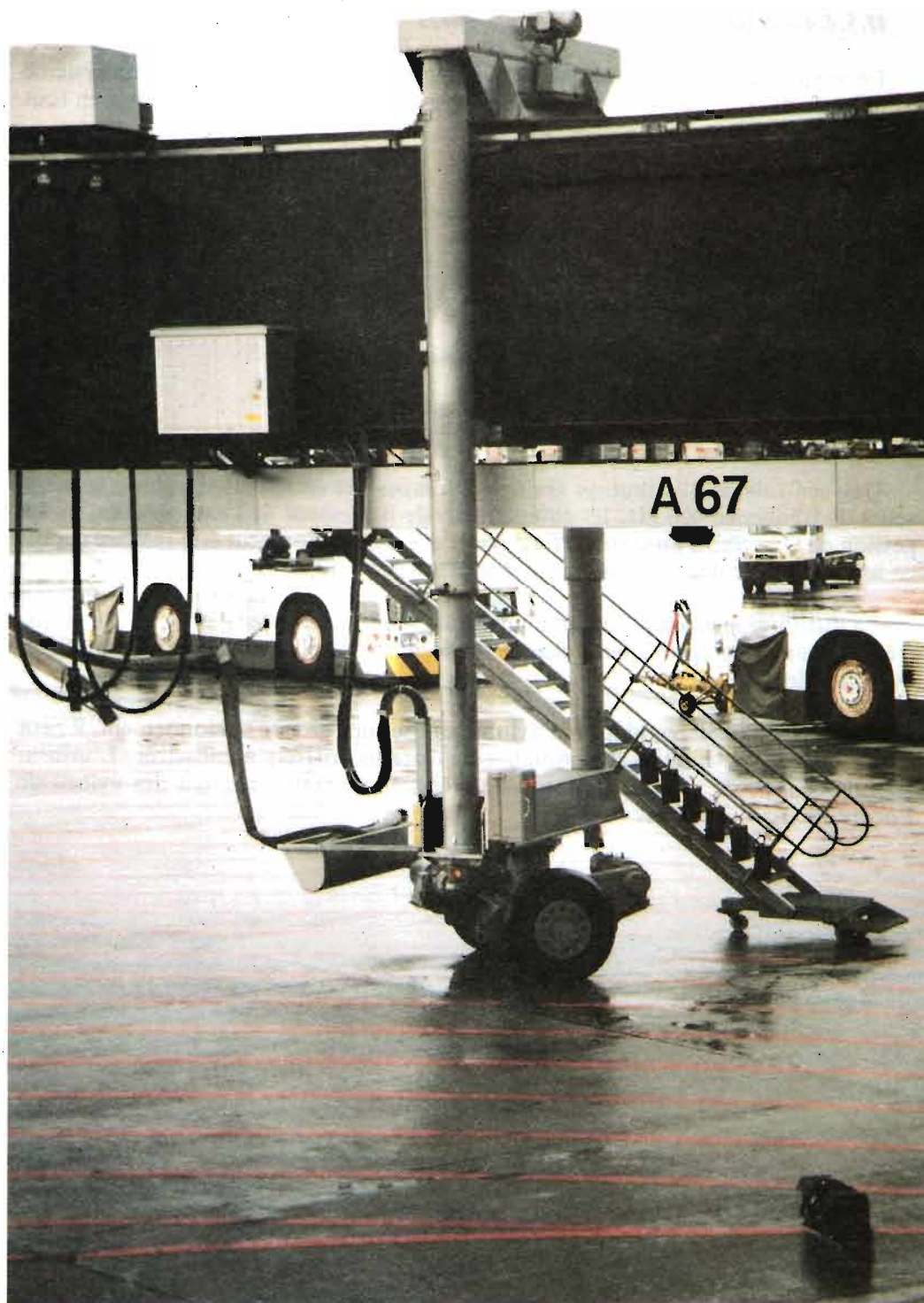
Equipements sur passerelle à Zürich-Kloten.
