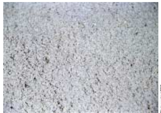
Aspect de surface avant mise en œuvre de la couche de roulement
